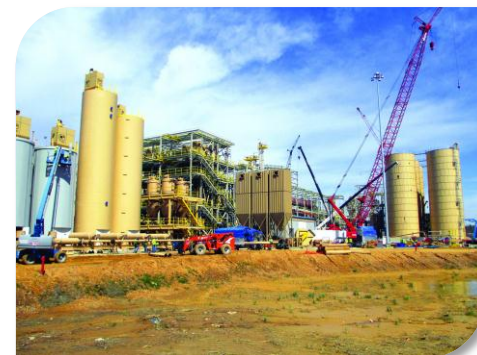
Nouvelle usine de proppants à Little Rock (AK)
